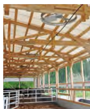
▲稼働中の細霧装置とファン(写真1)
